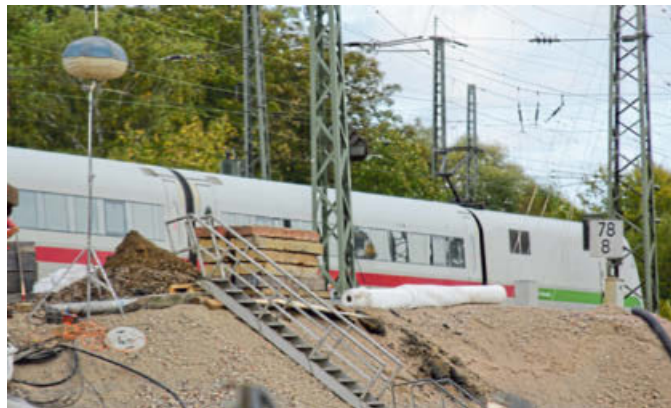
Die Brückenbaustelle verursacht erhebliche Veränderungen im Schienen-Nahverkehr zwischen Löhne und Minden. Foto: Ulf Hanke
